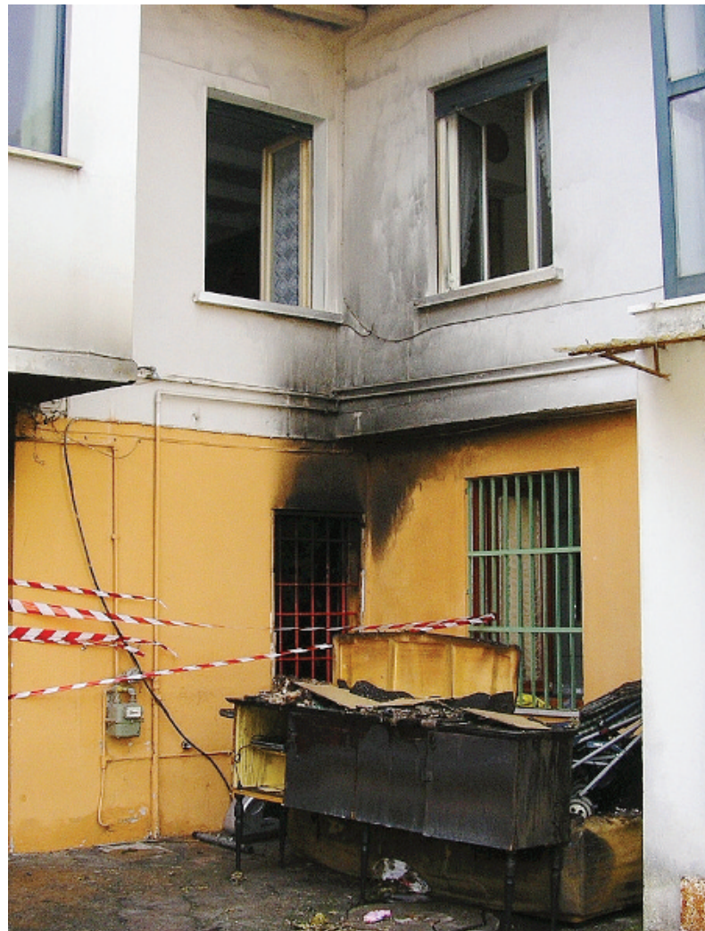
L'immobile di via Cesare Battisti danneggiato dalle fiamme
